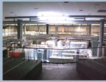
Inner power supply area of storage ring 蓄積リング内側電源エリア
