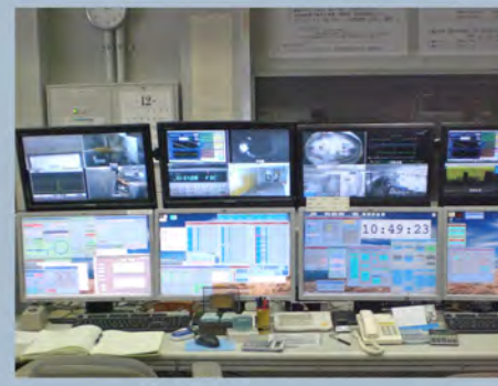
Control room console 制御室コンソール
